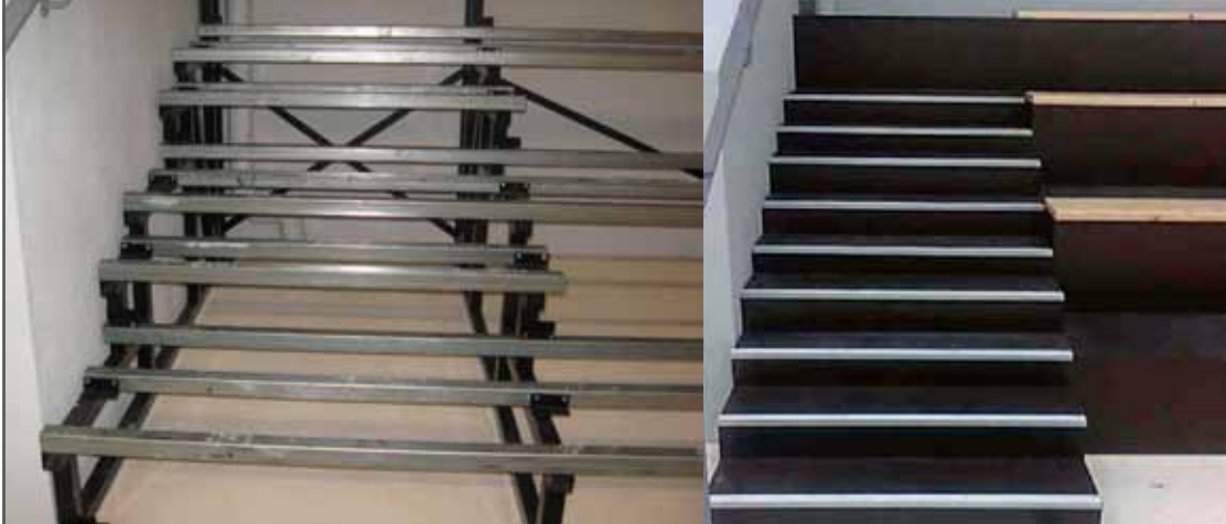
Base structurelle d'une tribune fixe
